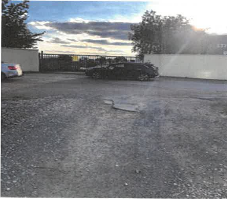
L'entrée de mon chemin d'accès (voir bitume très abimé)
